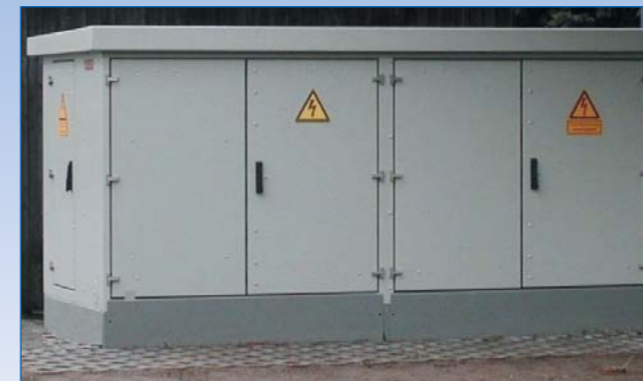
Trafo-Kompaktstation mit Edelstahl-Fundamentwanne, 630 kVA Öltransformator, Mittelspannungsschaltanlage und Niederspannungsverteilung
