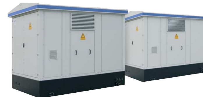
Beispiel einer PV-Netzstation PvTS
