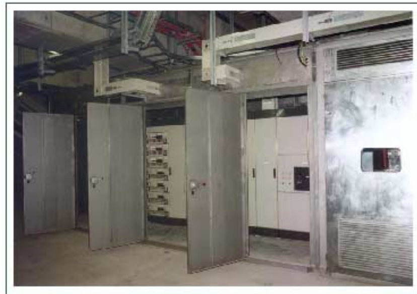
Aufstellung im Keller Anbindung an Stromschienen System
