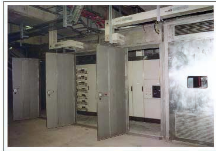
Aufstellung im Keller Anbindung an Stromschienen System
